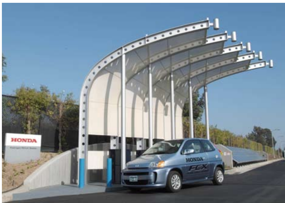
Herover ses et eksempel på en japansk brint tankstation, hvis elforbrug produceres med solceller. Foto: NHA
