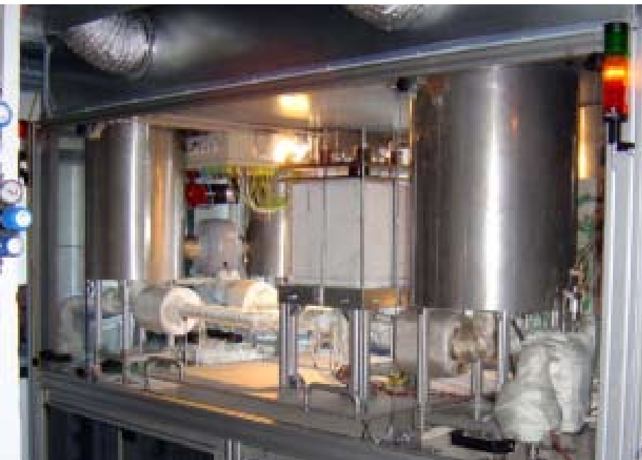
Topsoe Fuel Cell hører til de industrivirksomheder, der er kommet længst med udvikling af kommercielle brændselscelle produkter. Billedet viser en "Hot box". Foto: Topsoe Fuel Cell A/S og AVL LIST GMBH
